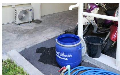
ถังรวมน้ำทิ้งแอร์
