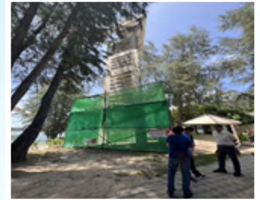
ภาพแสดง : การติดตั้งหอเตือนภัยเพิ่มเติมในพื้นที่เสี่ยงภัย
